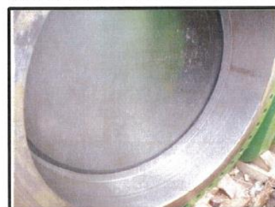
SE MUESTRA SELLO DE VALVULA QUE NO PRESENTA FUGAS
